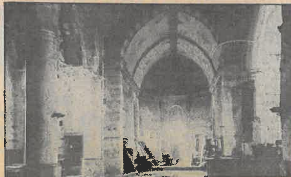
• De vervallen toestand waarin het oude kerkje te Middelbeers in de begin jaren zestig verkeerde. Als er niets aan de toren gedaan wordt, dan kan binnen enkele jaren dit weer het beeld zijn.
