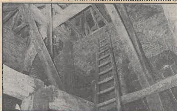
• Een beeld van de slechte toestand waarin de toren van het oude kerkje in Middelbeers verkeert. Door het dak kun je naar buiten kijken en wind en regen hebben vrij spel op het houtwerk van de toren.
